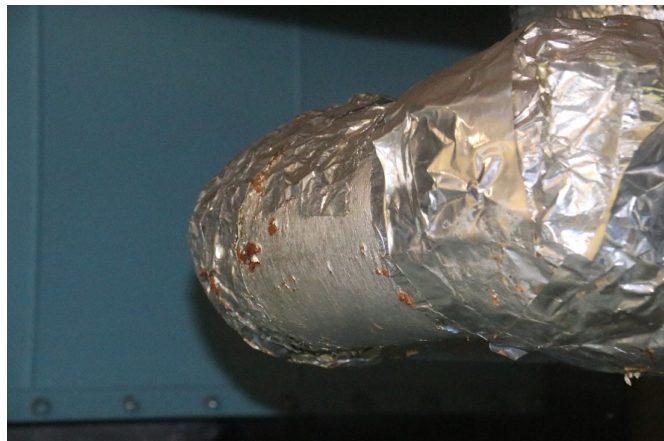
屋上 冷却水ポンプ廻り配管
