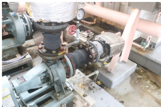
屋上 冷却水ポンプ
