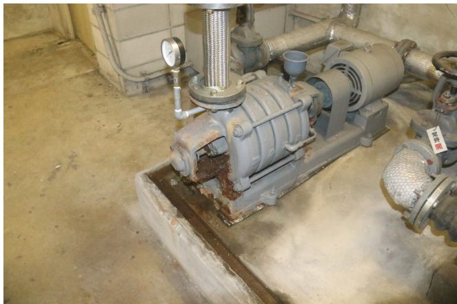
地下1階 ポンプ室 揚水ポンプ
