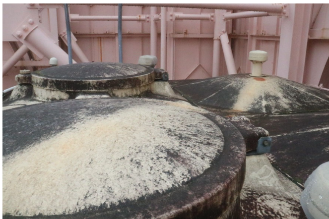
屋上 高架水槽
