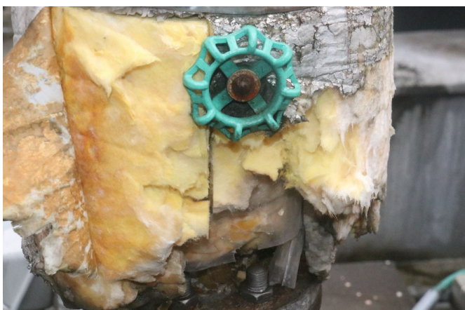
屋上 冷却水ポンプ廻り配管
